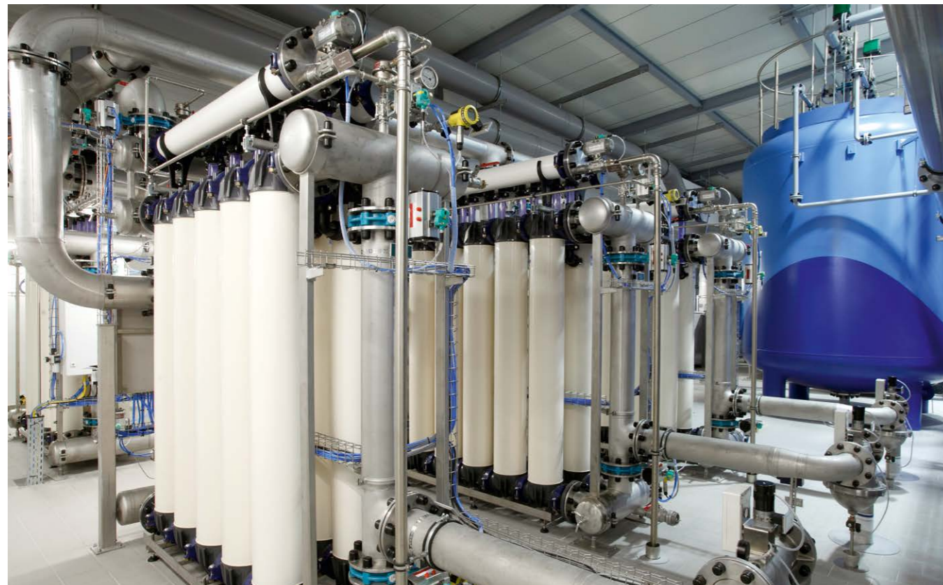
Ultrafiltrationsanlage (weiß) und Enthärtungsanlage (blau) im Wasserwerk Wart
