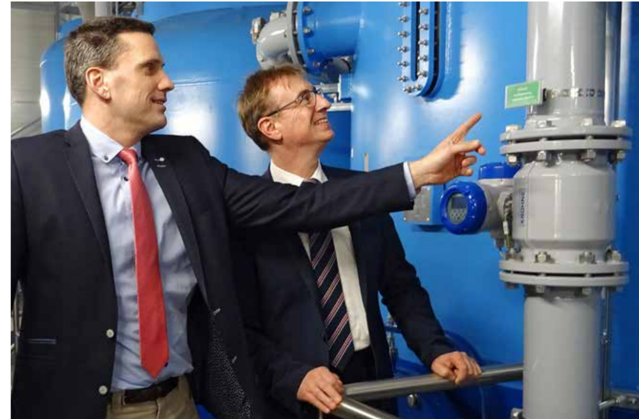
Geschäftsführer Dr. Jochen Damm (NOW) mit Verbandsvorsitzendem Bürgermeister Raimund Müller (Jagstgruppe) bei der Inbetriebnahme der Enthärtungsanlage im Wasserwerk Schweighausen.
