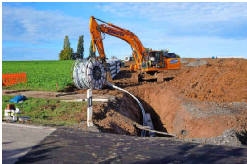
Drei Teams bauen für die Nord-Ost-Wasserversorgung eine neue Hauptwasserleitung für die Versorgung mit Bodenseewasser.
