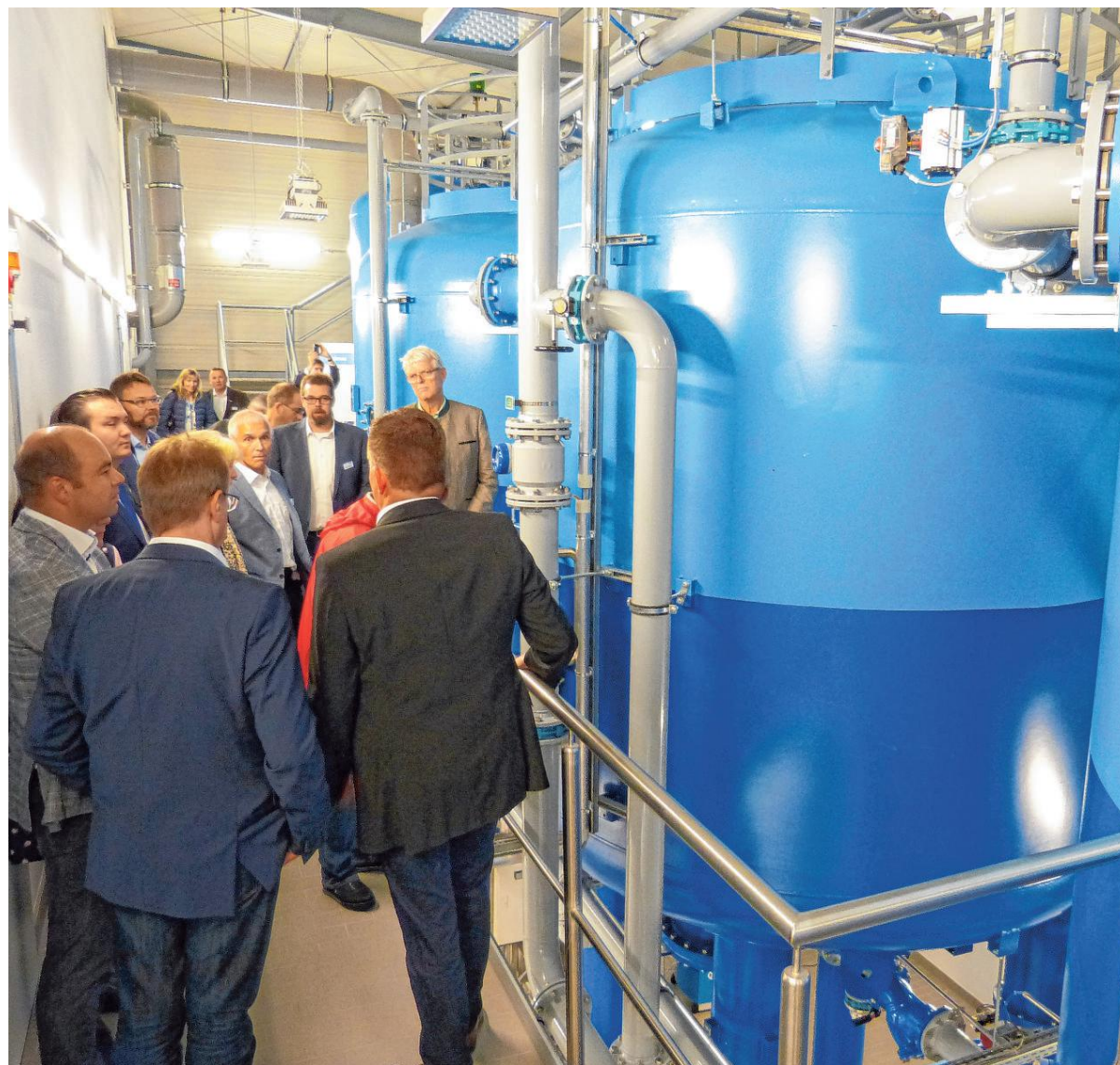
Großinvestition: Die neuen Wasserenthärtungsanlagen im Wasserwerk Scheigh.
