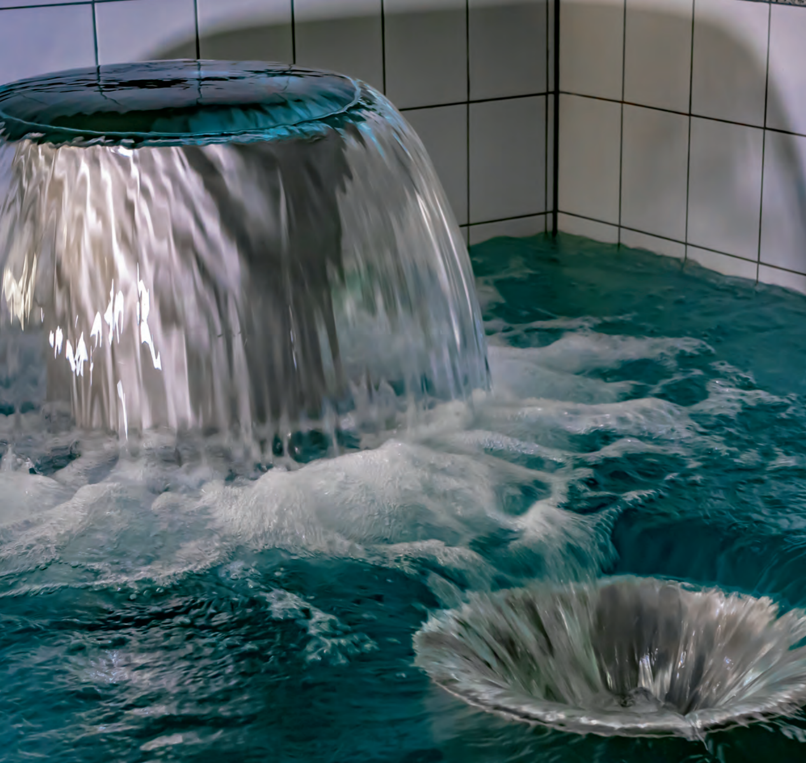
Mischkammer (in Reinwasserkammer)
