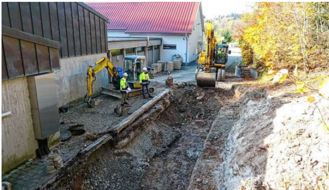
Aktuell laufen Tiefbauarbeiten für den Anbau am Wasserwerk Schweighausen, in dem die zusätzliche Ultrafiltrationsanlage untergebracht wird.
