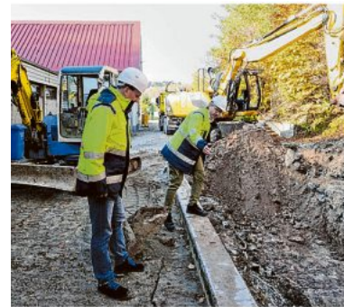
NOW-Projektleiter Stefan Bauer (rechts) zeigt NOW-Geschäftsführer Dr. Jochen die Baugrube beim Wasserwerk. Foto: NOW
